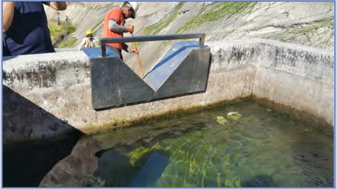
Figura N° 12: Vertederos rectangulares para medición de volumen de agua. Fuente: Alternegy, S.A.
