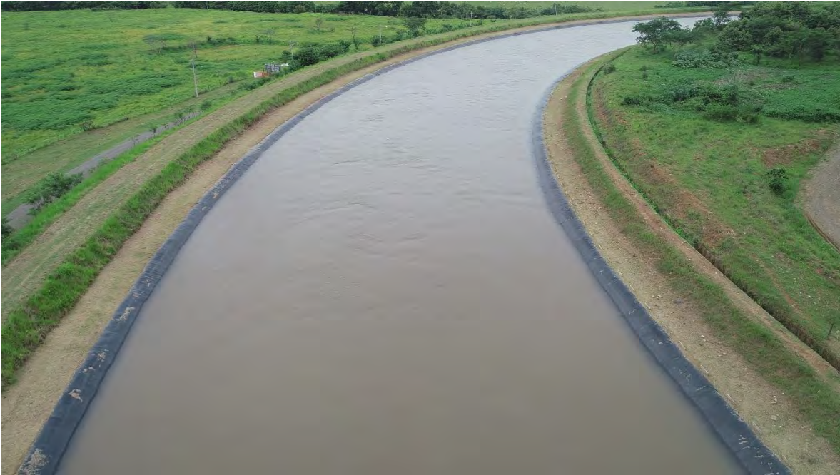
Figura N° 9: Vista de la limpieza y mantenimiento del pasto sobre los diques y canales. Fuente: Alternegy, S.A.
