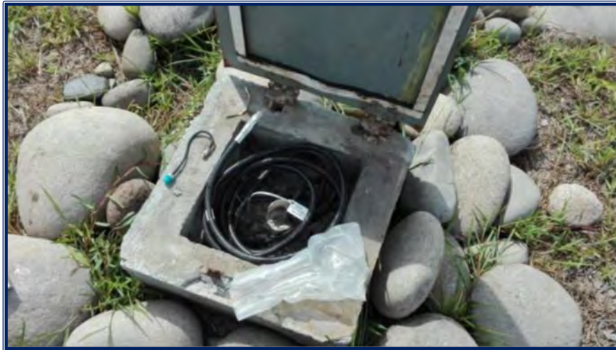
Figura N°13: Inclinómetro instalado en el canal de Aducción de Prudencia.
