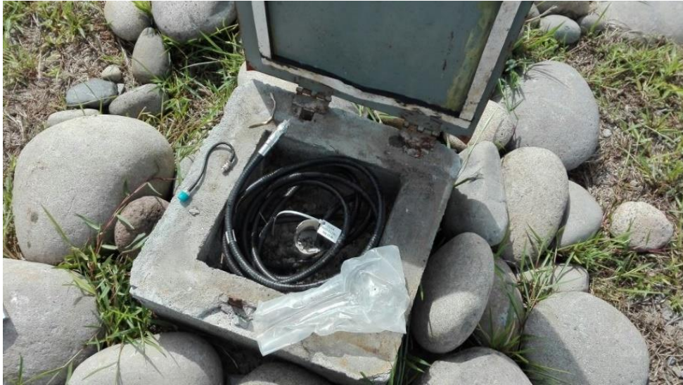
Figura N° 4 – Uno de los inclinómetros del canal de aducción. Fuente: Alternegy, S.A.
