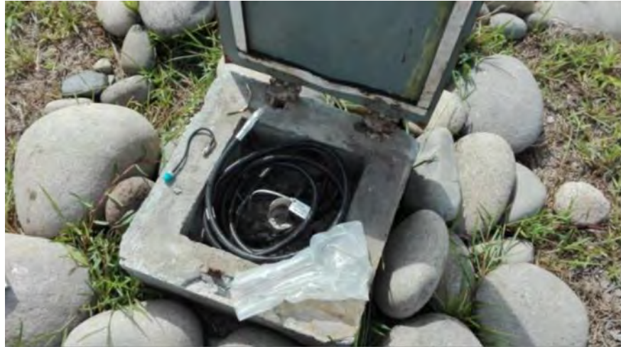
Figura N° 10: Inclinómetro instalado en el canal de Aducción de Gualaca
