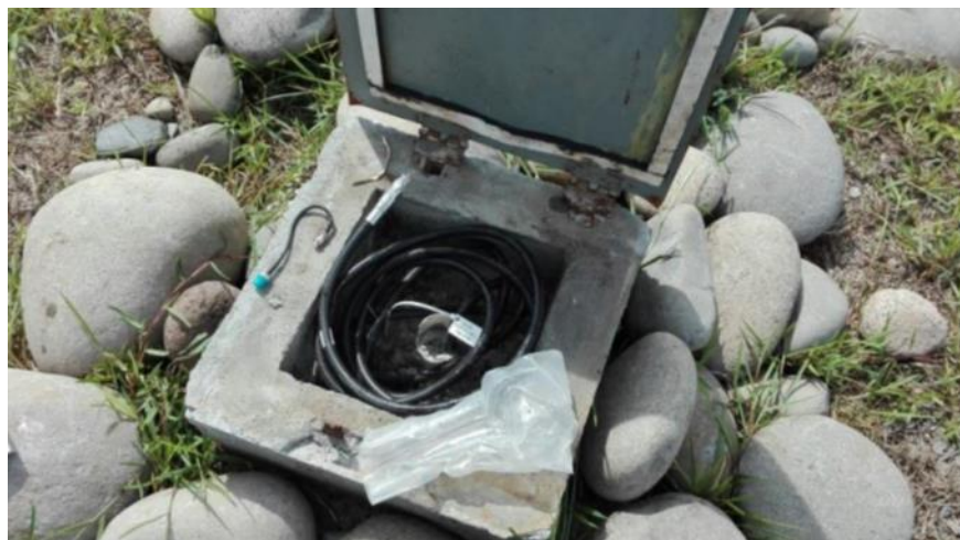
Figura N° 10: Inclinómetro instalado en el canal de Aducción de Gualaca
