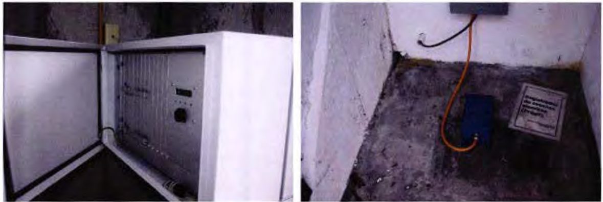
Figura No 7. . Registrador y acelerógrafo de la Presa. Fuente: Consultor, mayo 2013.
