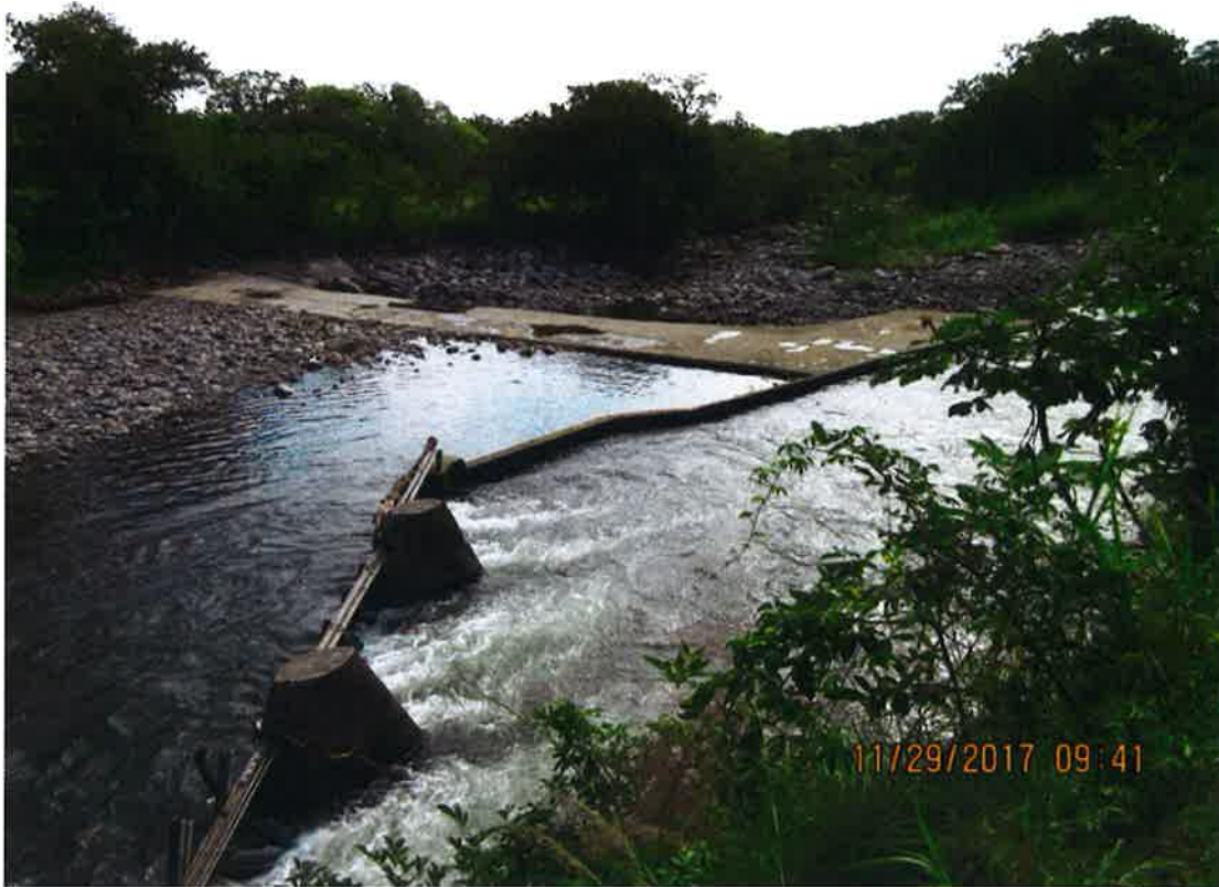
Foto N°1- Condición operativa de la Presa Dolega
