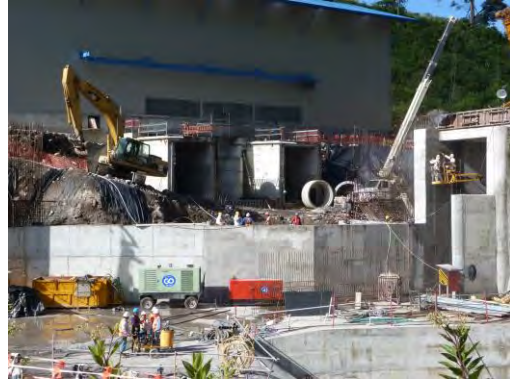
Foto 2. Vistas de casa de máquina de la Central Hidroeléctrica Pando ubicado a un costado de la presa Monte Lirio
