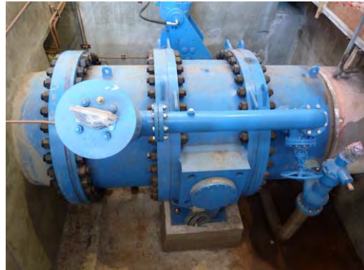
Foto 4. Vista de una de las válvulas que controlan el flujo de agua proveniente de la presa Pando
