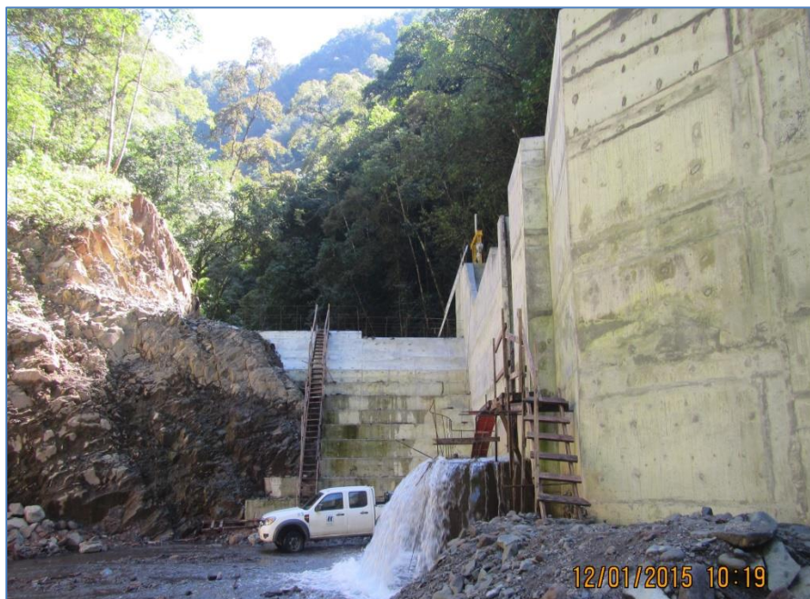
Figura N° 6 – Presa y vertedero tirolesa Eco Hidro Tizingal
