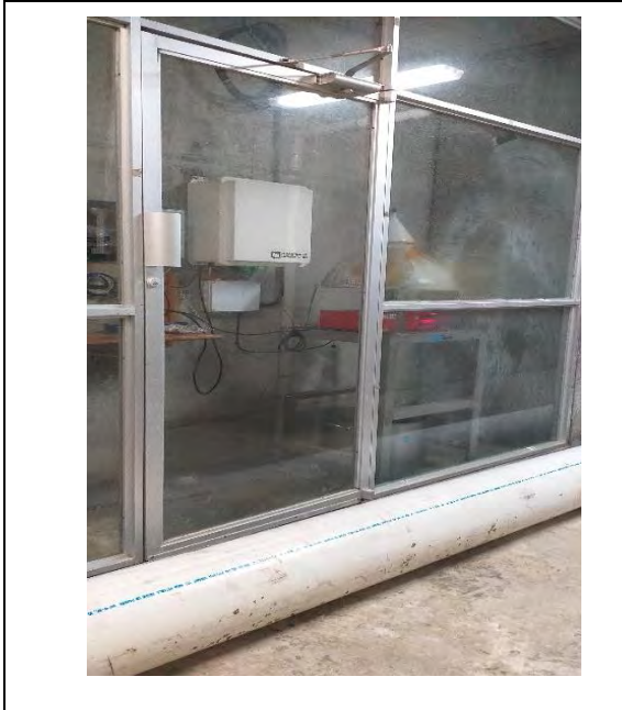
Péndulo, monitorear el desplazamiento horizontal de la presa.
