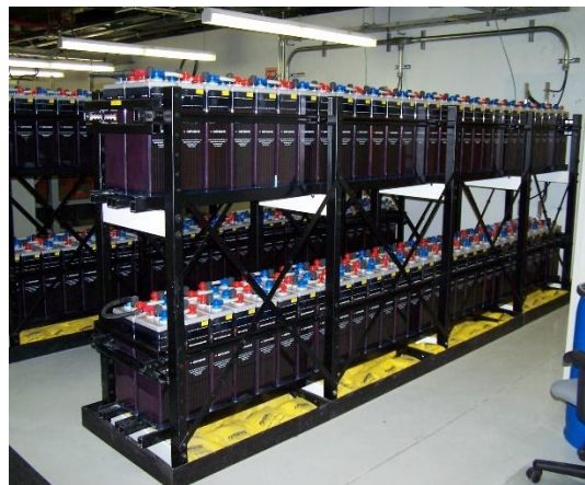
Figura 60: Banco de baterías de plomo ácido
