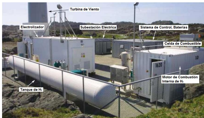
Figura 69: Central de almacenamiento de hidrógeno en Noruega.
