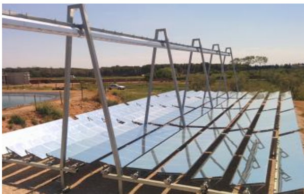
Figura 17: Ejemplo de reflectores Fresnel
