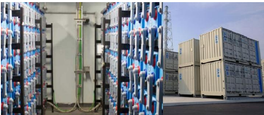
Figura 58: Interior de un módulo de baterías (izquierda) y módulo inversor (derecha).
