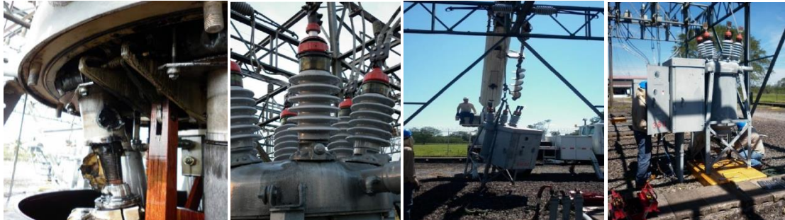
Figura No.5: Problema de daños en el aislador del interruptor 3M22 y sus efectos en el transformador
