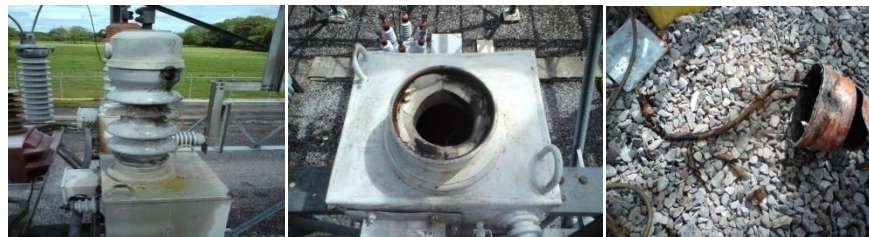
Figura No.6: Explosión del transformador de tensión
