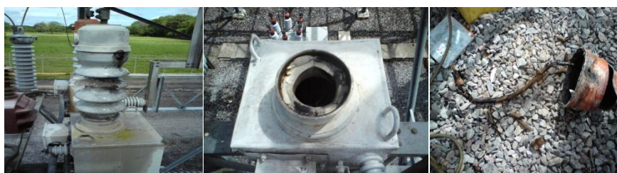
Figura No.7: Explosión del transformador de tensión
