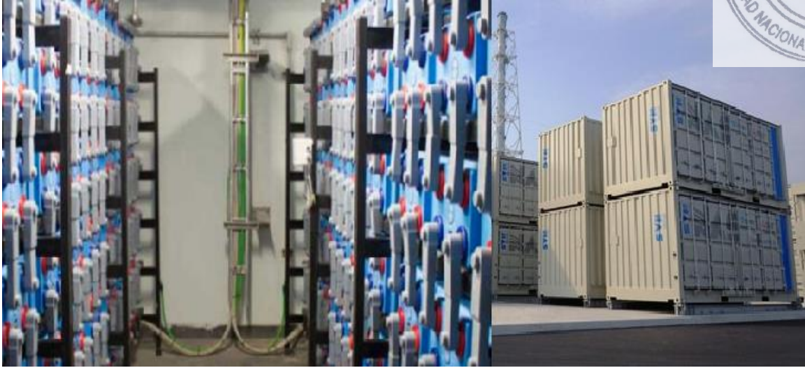
Figura 2. 39: Interior de un módulo de baterías (izquierda) y módulo inversor (derecha).
