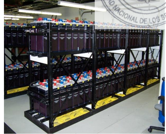
Figura 2. 41: Banco de baterías de plomo ácido
