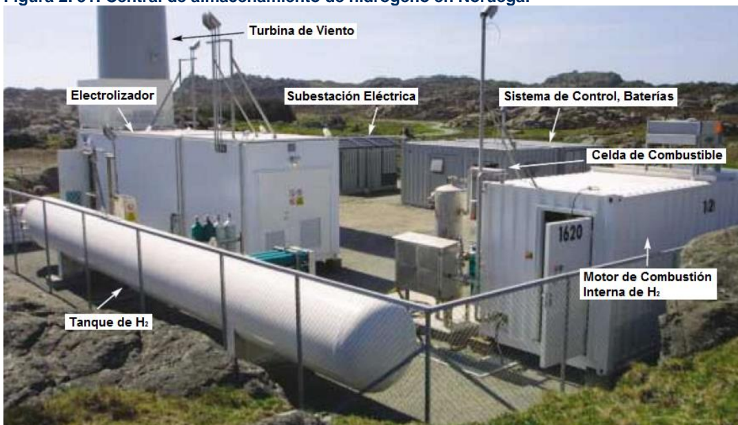
Figura 2. 51: Central de almacenamiento de hidrógeno en Noruega.
